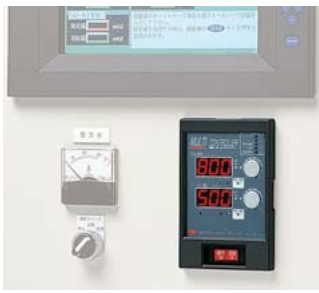
例1 制御盤に埋め込み
