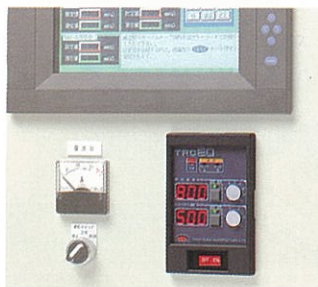
例1 制御盤に埋め込み
